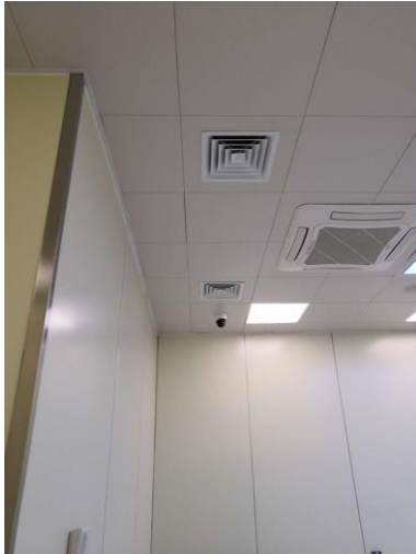
图 3-28 加速器机房进风口
