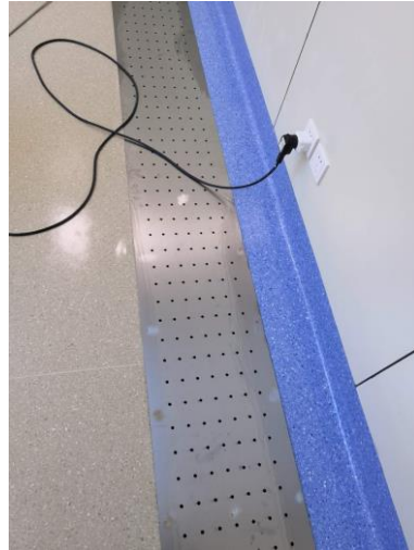
图 3-29 加速器机房出风口
