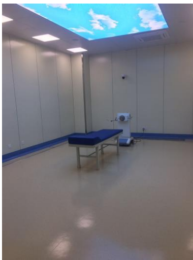
图 3-22 后装治疗机机房排风口
