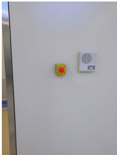
图 3-30 加速器机房内急停按钮
