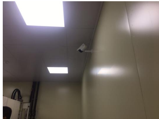
图 3-11 \gamma 回旋加速器机房内视频监控系统
