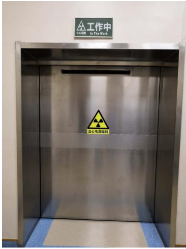
图 3-26 机房警示标志及指示灯
