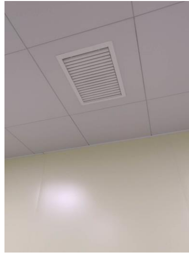
图 3-17 回旋加速器机房出风口
